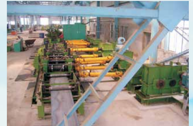
168mm ERW Pipe Mill
