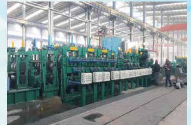
273mm ERW Pipe Mill
